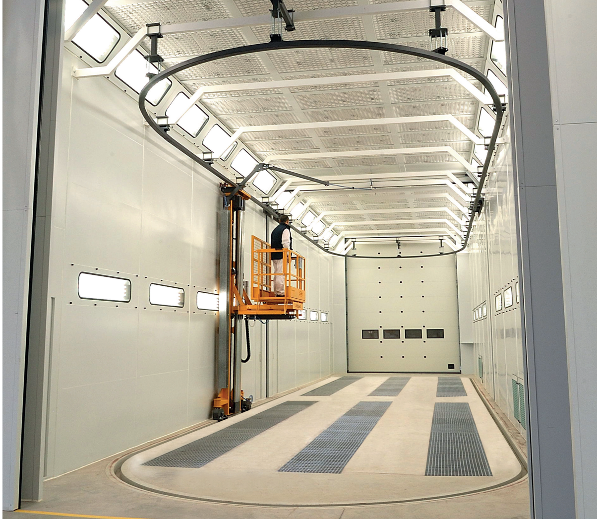
Cabina horno para el pintado de vehículos de grandes dimensiones.
