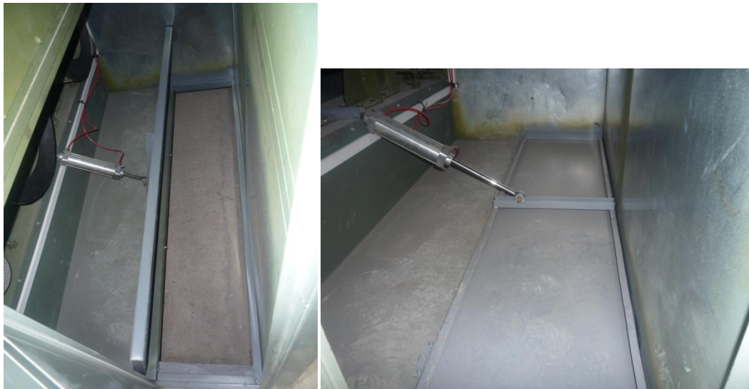
Fig. 6.12. Puerta de re circulación de aire
