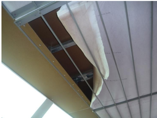
Fig. 6.9. Filtro en el techo.
