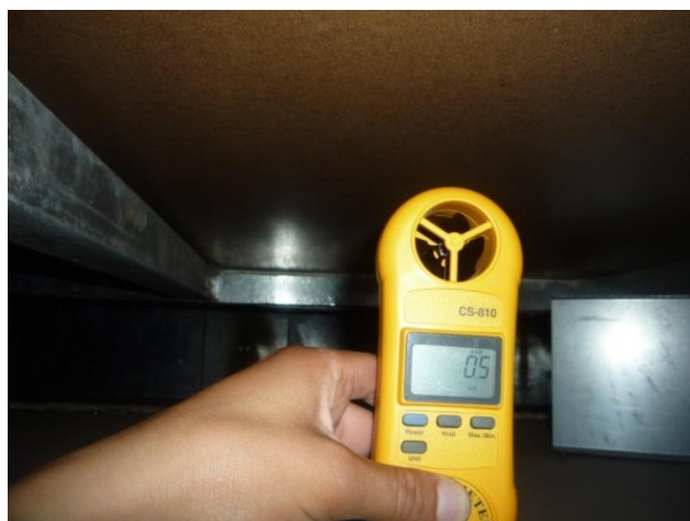
Fig. 6.11. Velocidad de aire caliente. Después del pintado.
