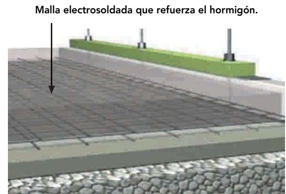
Figura 8 - 56: Colocación de la malla electrosoldada sobre separadores plásticos de 2 cm sobre la barrera de humedad.
