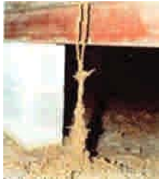
Figura 2 - 12: Túneles generados por las termitas subterráneas desde el terreno al friso, formando túneles con barro protector llamados tubo refugio. Conformados por fragmentos de tierra y madera digerida cementada con excrementos de las termitas obreras.
