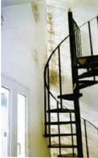
Figura 13 - 12: Formación de hongos en la superficie que se traduce en manchas, por efecto de la humedad por condensación.
