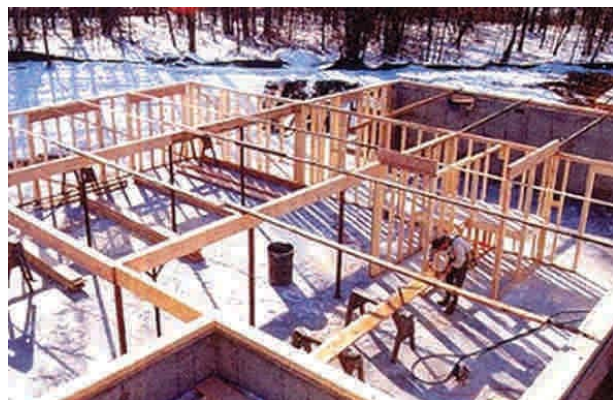
Figura 10 – 31: Tabiques ya estructurados en el primer piso de una vivienda. Durante el proceso de clavado y fijación, es primordial el control geométrico como: alineación, verticalidad (plomada), anchos, largos y espesores con respecto al diseño planimétrico y altimétrico de la vivienda.
