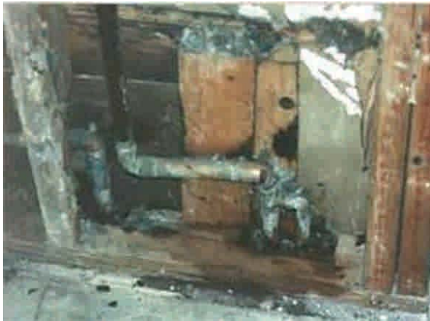
Figura 2 – 13: En tabique sanitario, la presencia de humedad por una pequeña filtración de la cañería de agua, crea el ambiente propicio en el interior del tabique para la presencia de termitas subterráneas. Se puede observar la destrucción del pie derecho y solera inferior.
