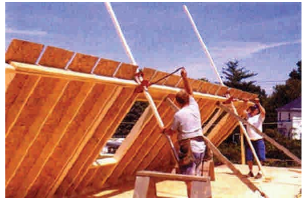
Figura 10 - 77: Etapa de montaje de muros prefabricados en obra directamente sobre la plataforma.
