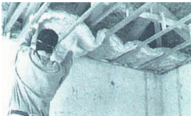
Figura 14 - 19: Colocación y despliegue del rollo de aislación de lana de vidrio o roca, entre los listones donde irán colocadas planchas de yeso del cielo.
