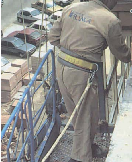
Figura 4 - 11: Al desarrollar una actividad en andamios, el trabajador debe siempre utilizar cinturón de seguridad.
